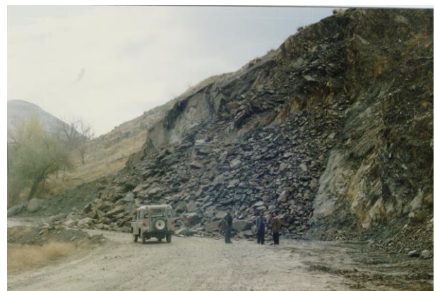
شکل (10): ناپایداری دامنه‌ها در یکی از جاده‌های اطراف شهر همدان
